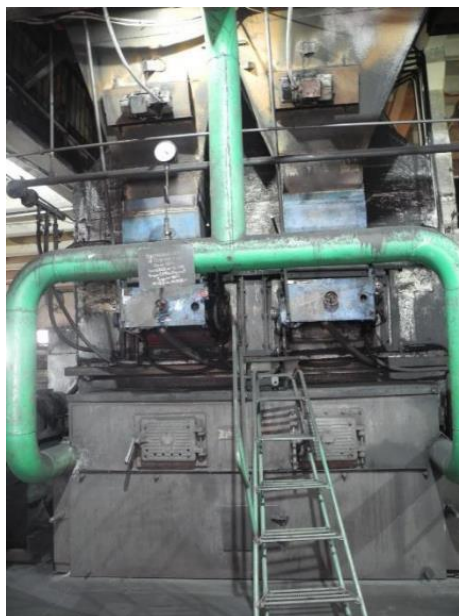
Рисунок 1.2.3 – Общий вид котла № 1
