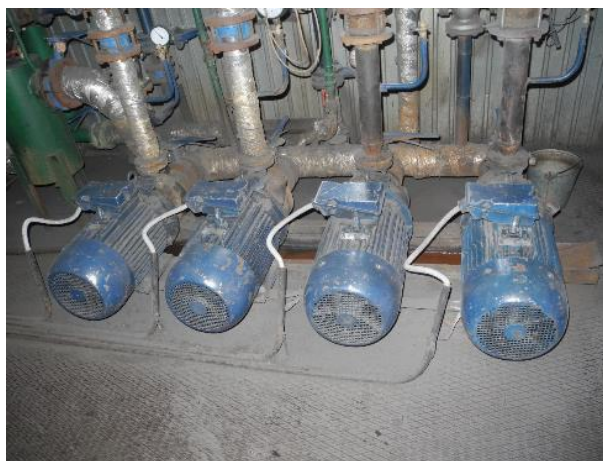
Рисунок 1.2.90 – Сетевые насосы КМ100-65-200, 30 кВт
