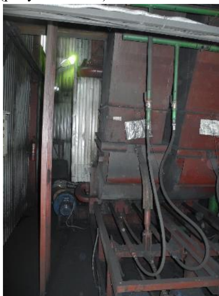
Рисунок 1.2.65 – Общий вид котла КВм – 2,32
