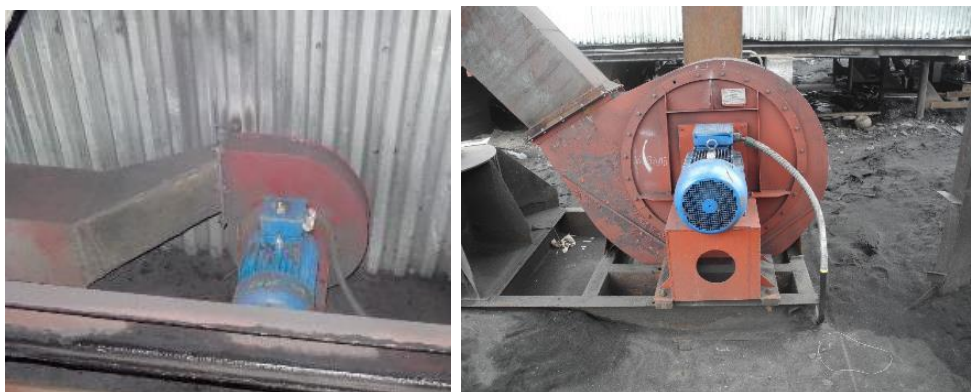
Рисунок 1.2.51 – Дутьевой вентилятор и дымосос
