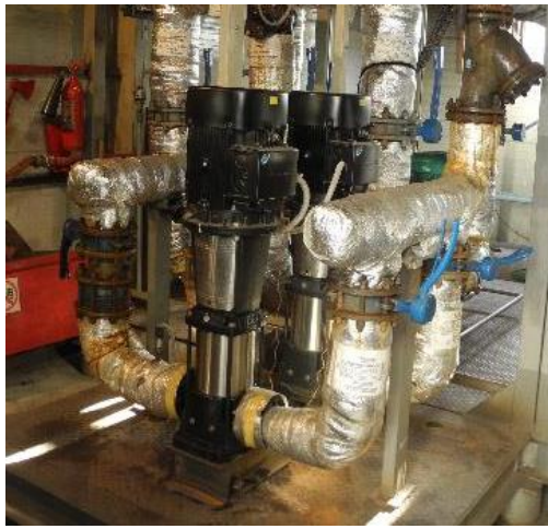
Рисунок 1.3.31 – Подпиточные насосы WiLo-IL 65/200-15/2, 15 кВт Внешний вид щита управления насосами ЦТП представлен на рисунках 1.3.32 – 1.3.35.
