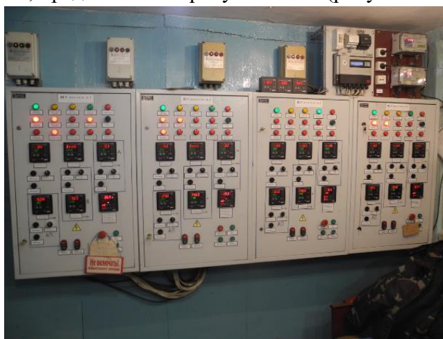
Рисунок 1.2.30 - Щит управления котлами
