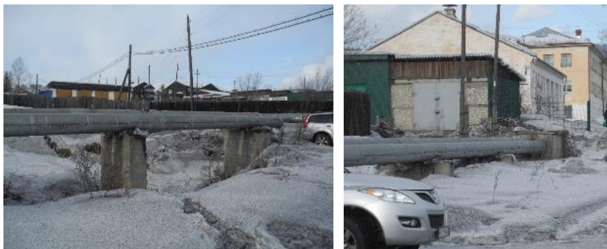
Рисунок 1.2.75 – Тепловые сети, проложенные надземным способом от котельной БМК
