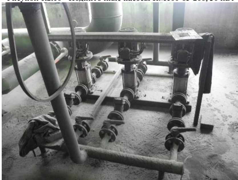
Рисунок 1.2.11 - Подпиточные насосы KSB Movitec VSF 15/06 14, 5,5 кВт
