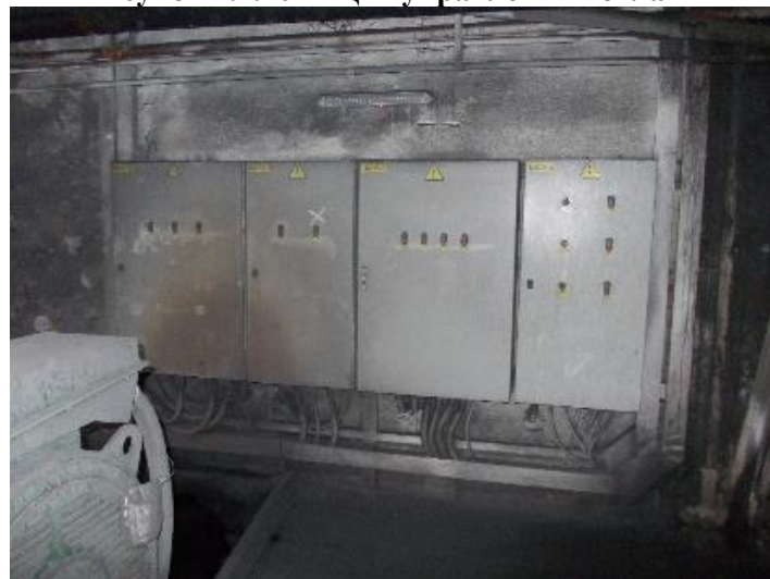
Рисунок 1.2.17 – Щит управления насосами
