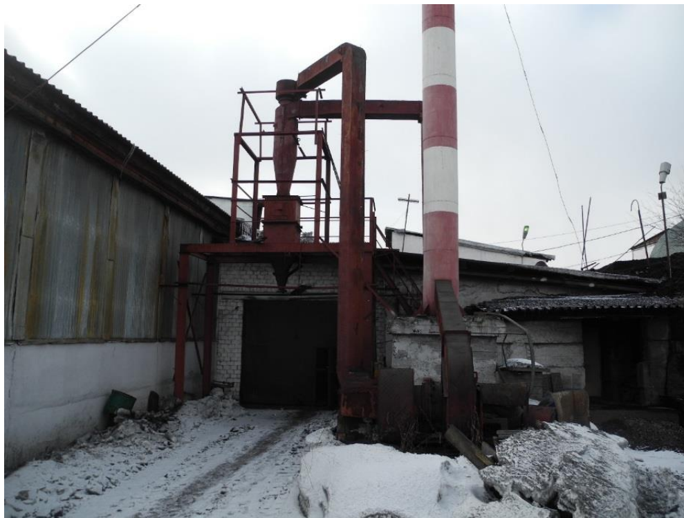
Рисунок 1.2.109 - Общий вид котельной «Витимэнерго»
