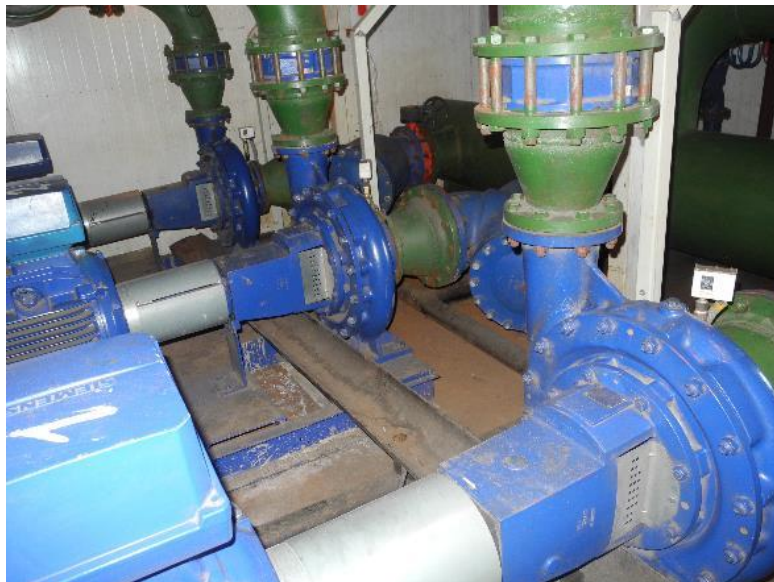
Рисунок 1.3.25 – Циркуляционные насосы KSB Etanorm RG 150-500/1, 160 кВт
