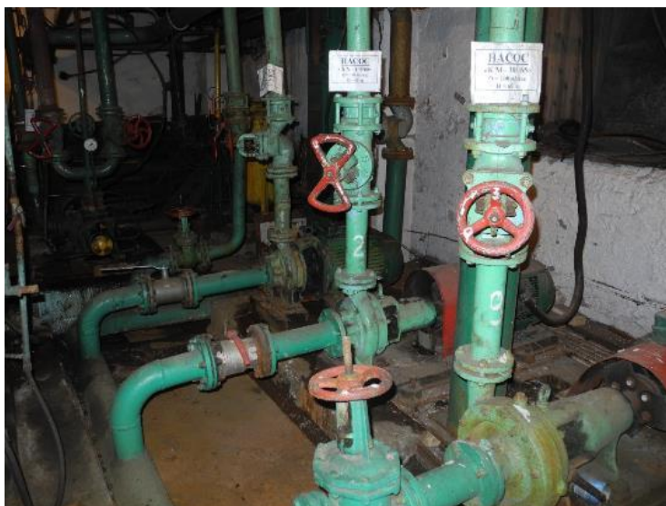
Рисунок 1.2.28 – Подпиточные насосы КМ100-65-200 и КМ80-50-160 Дымовые трубы находятся в исправном состоянии (рисунок 1.2.29).
