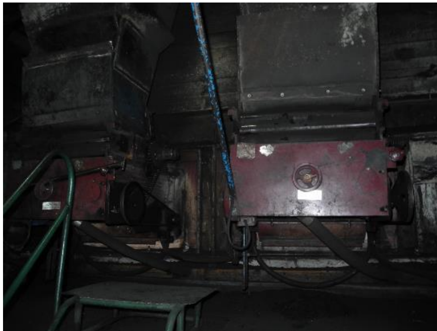
Рисунок 1.2.4 – Общий вид котла № 2.
