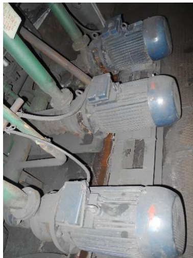
Рисунок 1.2.80 – Сетевые насосы КМ100-65-200, 30 кВт
