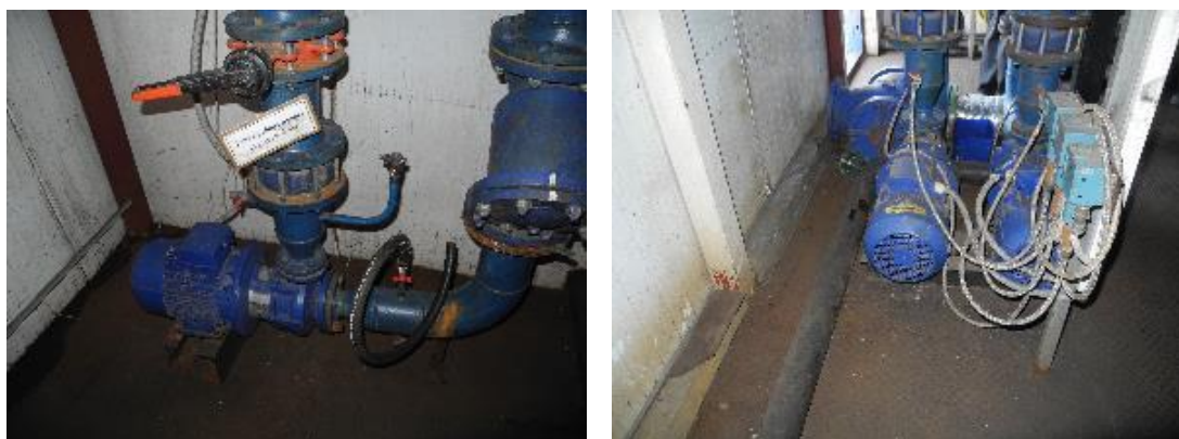
Рисунок 1.3.26 – Подпиточные насосы KSB Etanorm RG 150-500/1, 160 кВт и Etabloc GN 040-160/752 G 11, 7,5 кВт
