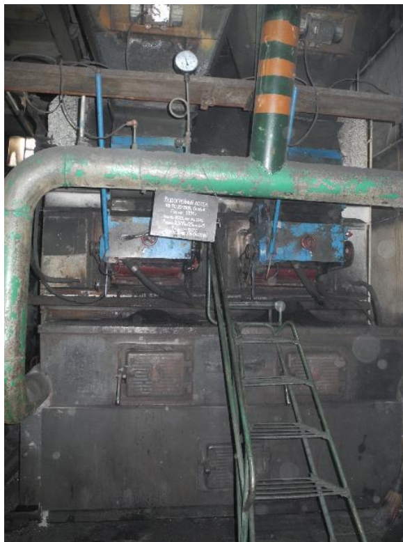
Рисунок 1.2.7 – Общий вид котла №4
