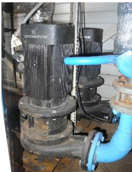
Рисунок 1.3.28 – Подпиточные насосы Grundfos LP 80-160/164, 7,5 кВт
