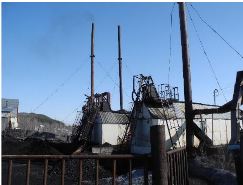
Рисунок 1.2.76 – Общий вид котельной МК-135
