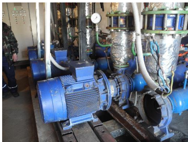
Рисунок 1.3.29 – Циркуляционные насосы KSB ETABLOC 65-250/4502 GN6, 45 кВт
