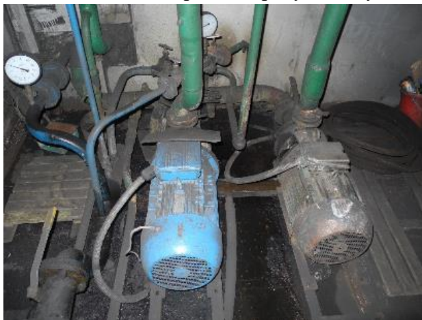
Рисунок 1.2.37 – Сетевые насосы К 80-50-200, 15кВт Дымовая труба котла – в работоспособном состоянии (рисунок 1.2.38).
