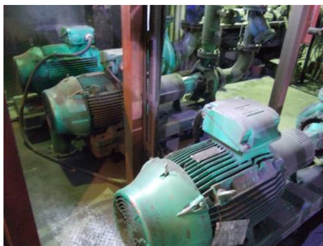
Рисунок 1.2.67 – Сетевые насосы Wilo NL 100/250-55-2-12, 55 кВт и Wilo NL 150/400-55-4-12, 55 кВт
