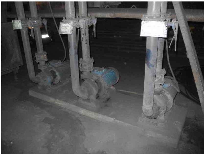
Рисунок 1.2.10 - Подпиточные насосы KM100-65-200, 30 кВт
