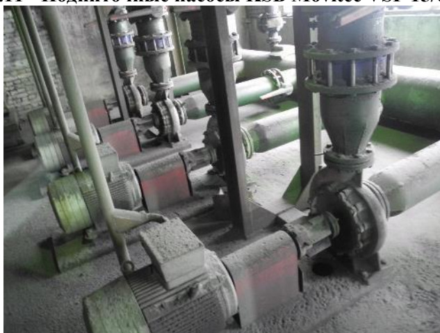
Рисунок 1.2.12 - Рециркуляционные насосы KSB Etanorm 125-315, 30 кВт
