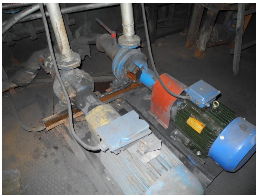
Рисунок 1.2.116 - Сетевые насосы КМ100-65-200, 30 кВт
