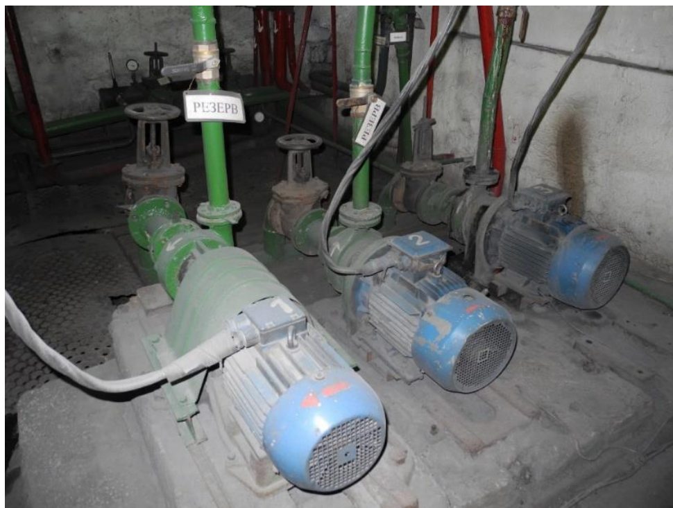
Рисунок 1.2.113 - Сетевые насосы КМ100-65-200, 30 кВт
