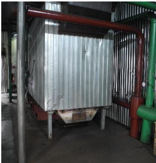
Рисунок 1.2.45 – Общий вид котла КВм – 2,5
