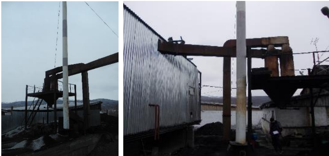
Рисунок 1.2.49 – Дымовые трубы котлов КВм – 2,5
