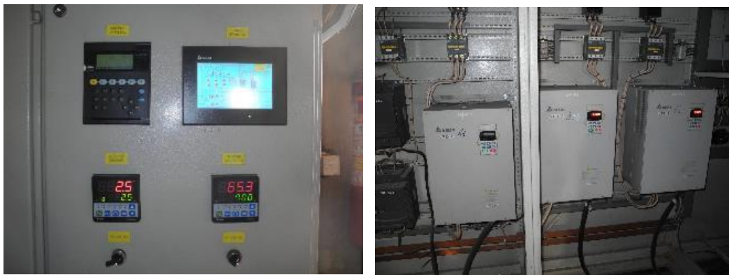
Рисунок 1.3.35 – Щит управления ЦТП №6
