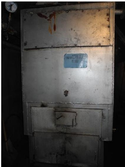
Рисунок 1.2.36 – Общий вид котла КСВм – 1,25 Сетевые насосы К 80-50-200, 15кВт – исправны, требуют текущего ремонта (рисунок 1.2.37).
