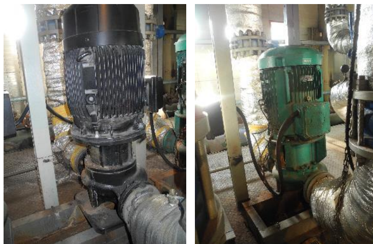
Рисунок 1.3.30 – Циркуляционные насосы WiLo-IL 100/210-37/2, 37 кВт и Grundfos TP 100-480/2, 30 кВт
