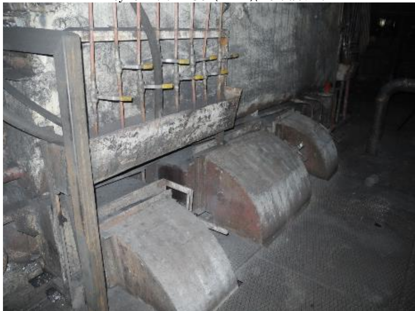
Рисунок 1.2.5 – Котел №2. Вид сбоку.
