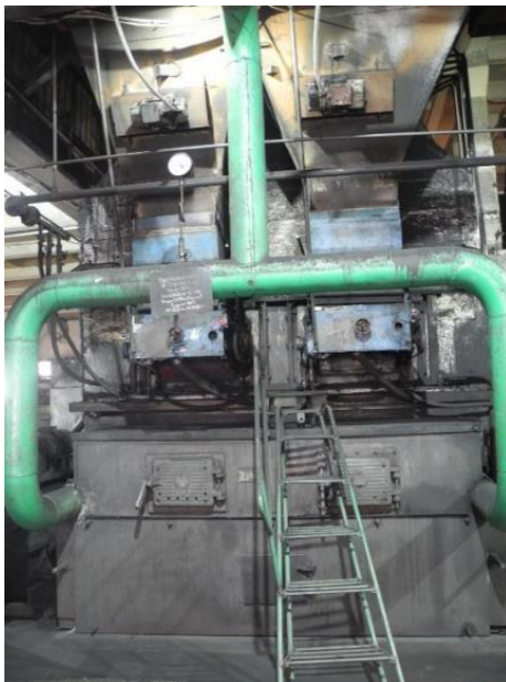
Рисунок 3.1.3 – Общий вид котла № 1
