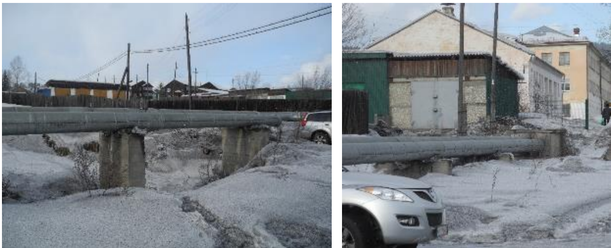
Рисунок 3.1.67 – Тепловые сети, проложенные надземным способом от котельной БМК
