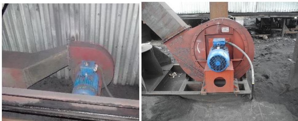
Рисунок 3.1.48 – Дутьевой вентилятор и дымосос
