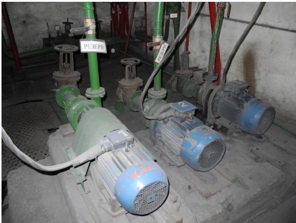
Рисунок 3.1.106 - Сетевые насосы КМ100-65-200, 30 кВт
