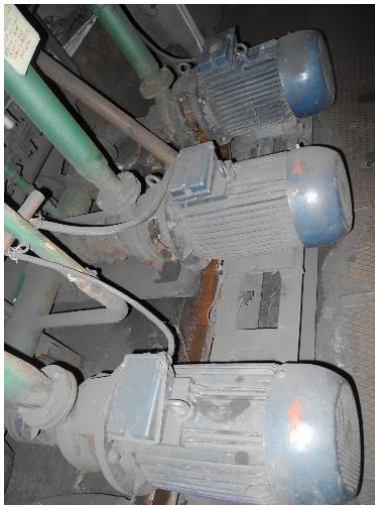
Рисунок 3.1.72 – Сетевые насосы KM100-65-200, 30 кВт
