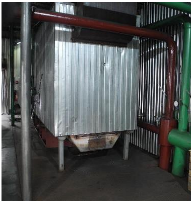
Рисунок 3.1.44 – Общий вид котла КВм – 2,5
