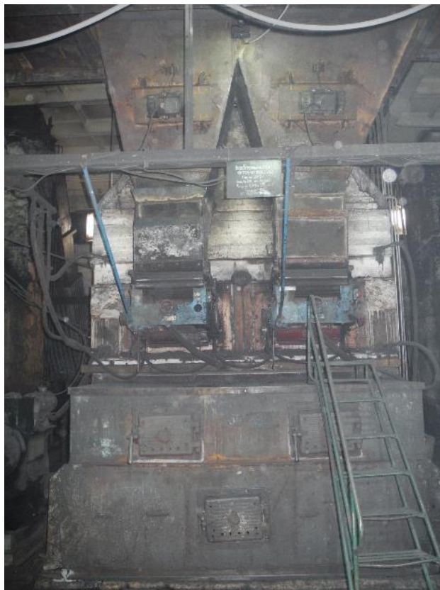
Рисунок 3.1.6 – Общий вид котла №3.
