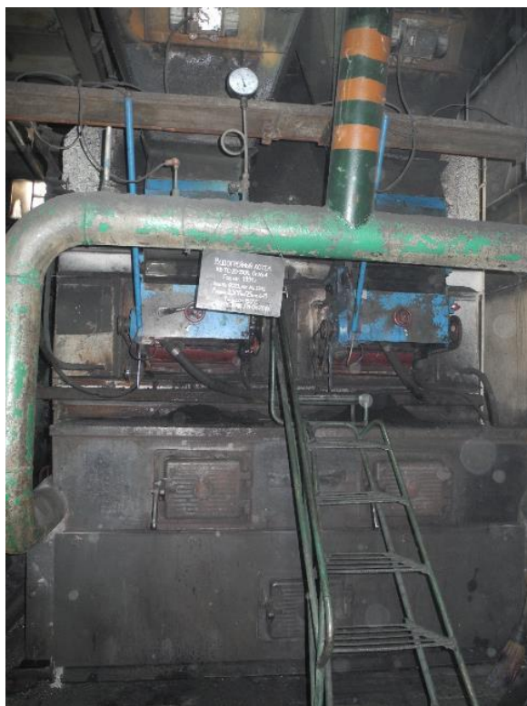
Рисунок 3.1.7 – Общий вид котла №4
