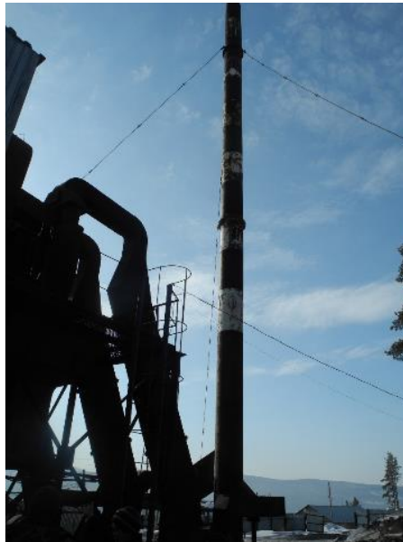
Рисунок 3.1.84 – Дымовая труба котельной МО-44
