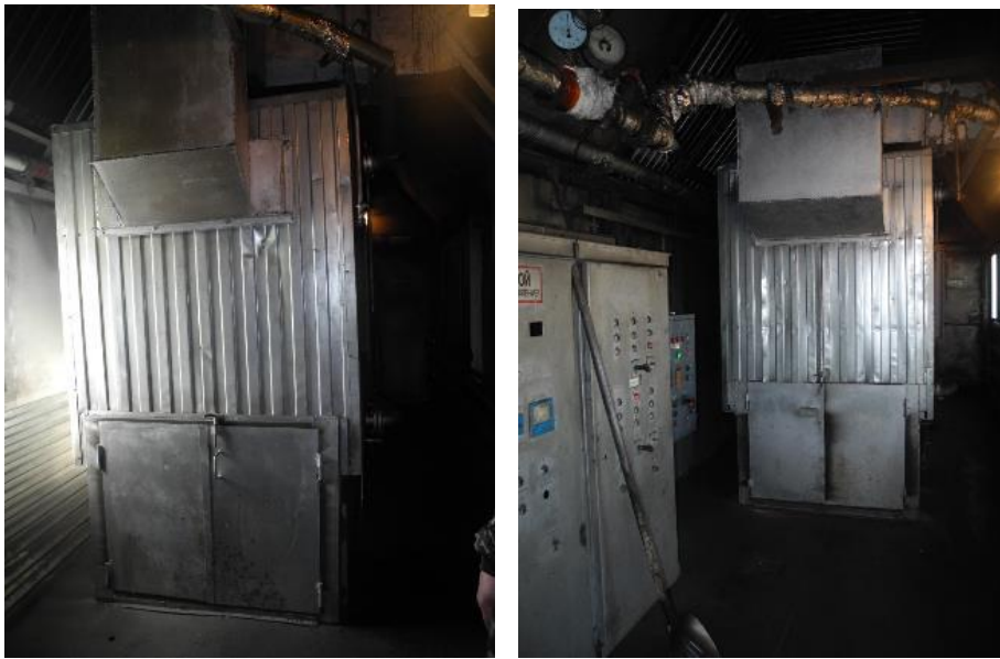
Рисунок 3.1.70 – Общий вид котла KVm-1,25-95ШП
