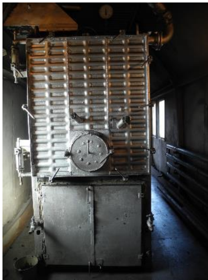
Рисунок 3.1.71 – Общий вид котла KСВм- 1,25К
