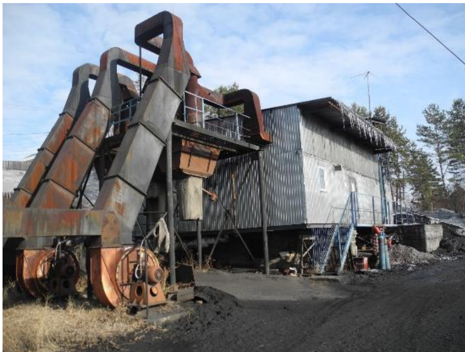
Рисунок 3.1.78 – Общий вид котельной МО-44
