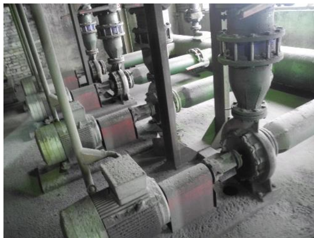
Рисунок 3.1.12 - Рециркуляционные насосы KSB Etanorm 125-315, 30 кВт
