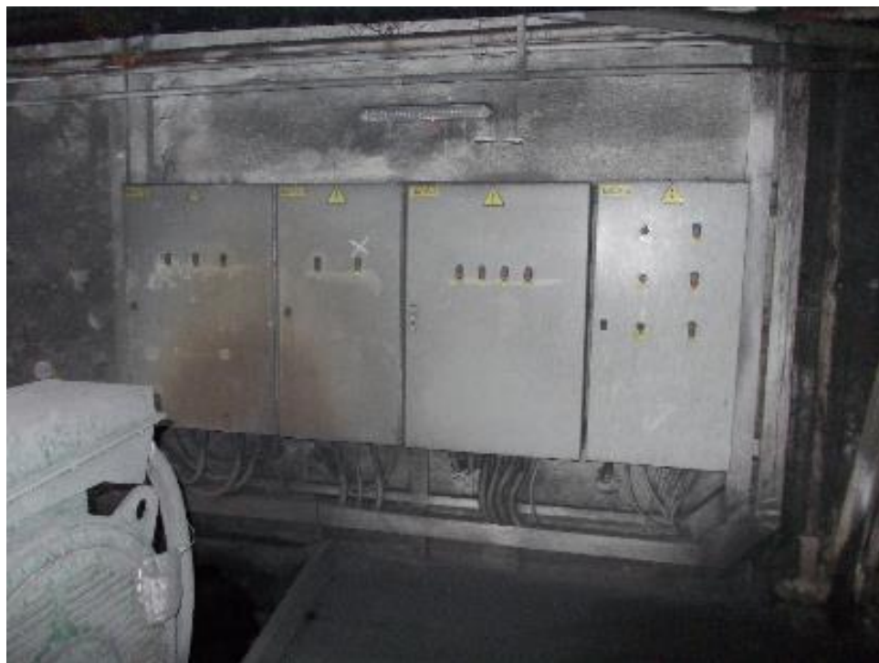
Рисунок 3.1.17 – Щит управления насосами
