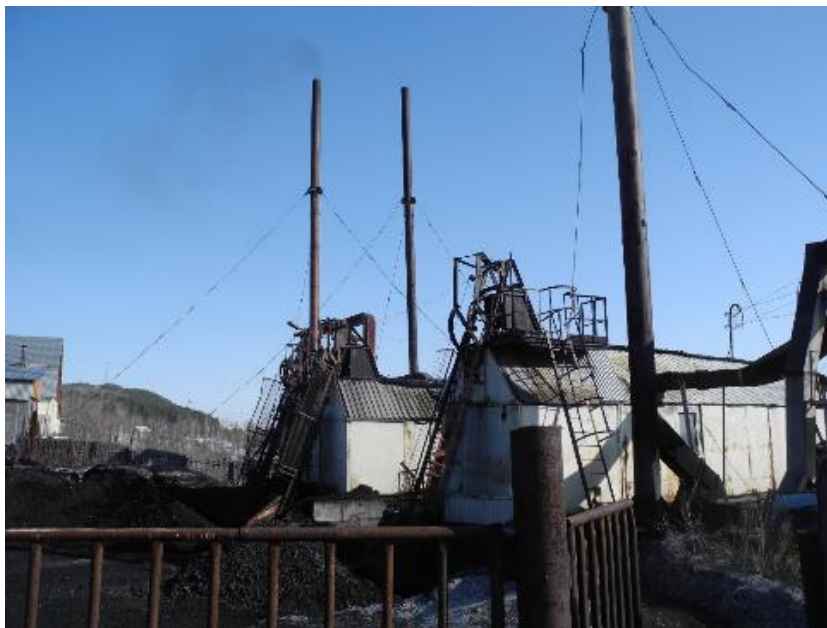
Рисунок 3.1.68 – Общий вид котельной МК-135
