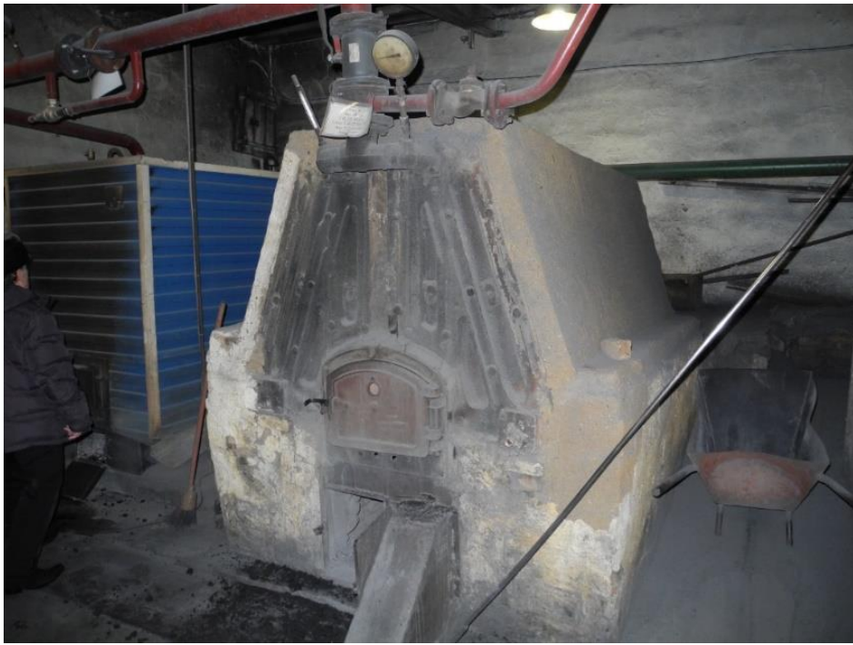
Рисунок 3.1.105 - Общий вид котла Универсал-6
