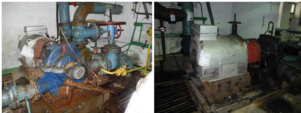
Рисунок 3.2.8 – Насосы 1Д630-90, установленные на НС №2
