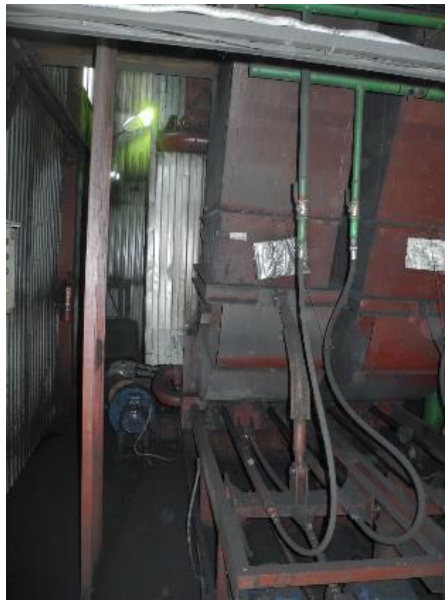
Рисунок 3.1.57 – Общий вид котла КВм – 2,32
