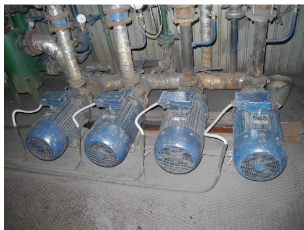
Рисунок 3.1.82 – Сетевые насосы КМ100-65-200, 30 кВт
