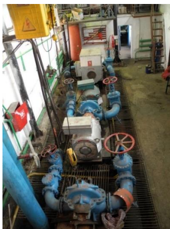
Рисунок 3.2.9 – Насосы типа 1Д630-90, установленные на НС №2
