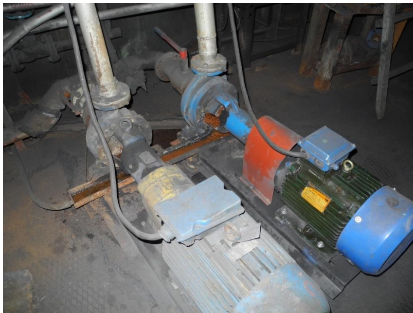
Рисунок 3.1.109 - Сетевые насосы КМ100-65-200, 30 кВт
