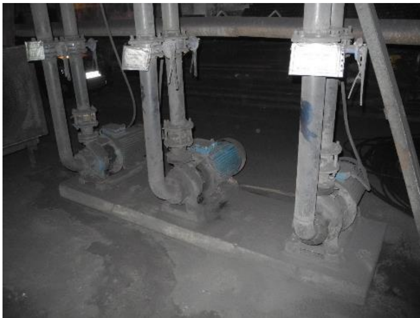
Рисунок 3.1.10 - Подпиточные насосы KM100-65-200, 30 кВт
