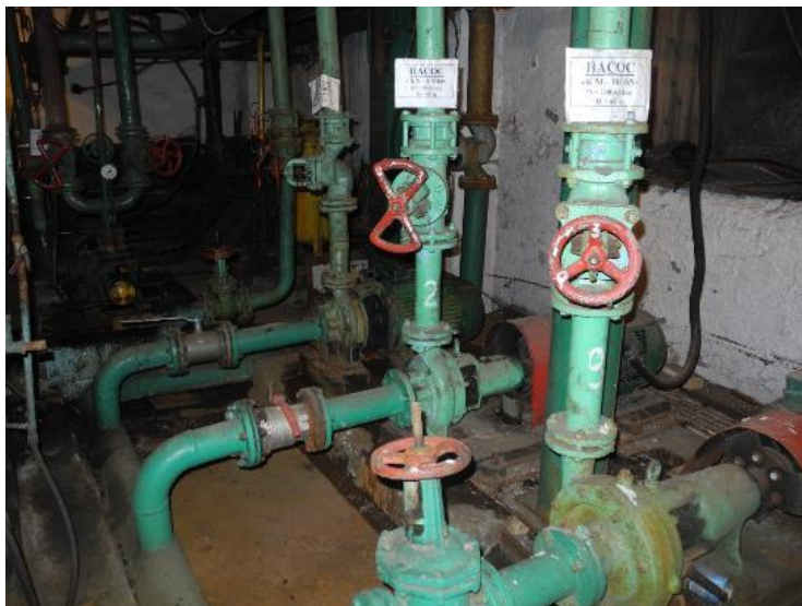
Рисунок 3.1.28 – Подпиточные насосы КМ100-65-200 и КМ80-50-160
