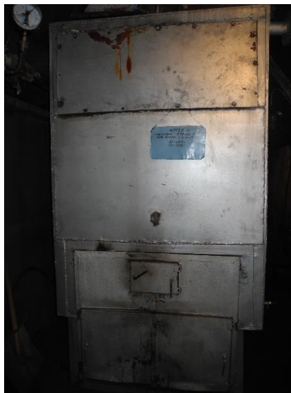
Рисунок 3.1.36 – Общий вид котла КСВм – 1,25
