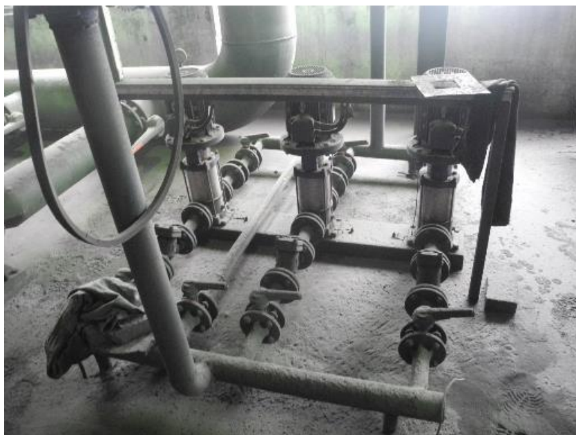
Рисунок 3.1.11 - Подпиточные насосы KSB Movitec VSF 15/06 14, 5,5 кВт
