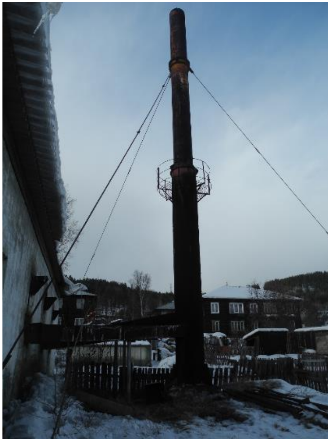
Рисунок 3.1.53 – Дымовая труба котельной «Металлист»
