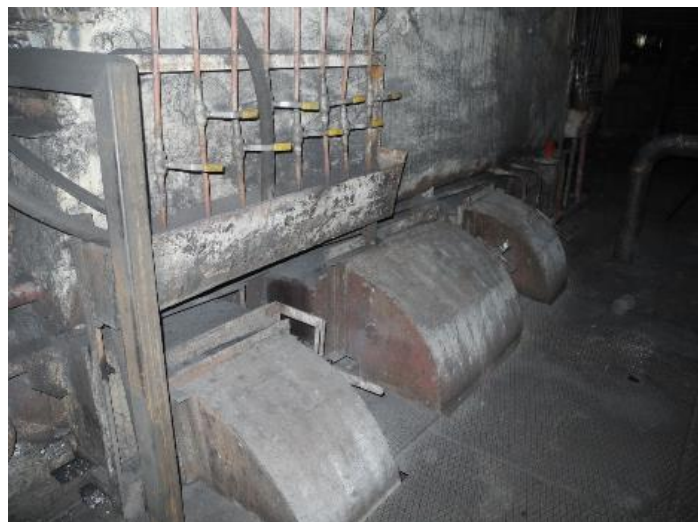
Рисунок 3.1.5 – Котел №2. Вид сбоку.
