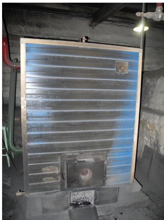
Рисунок 3.1.104 - Общий вид котла КВр-0.6
