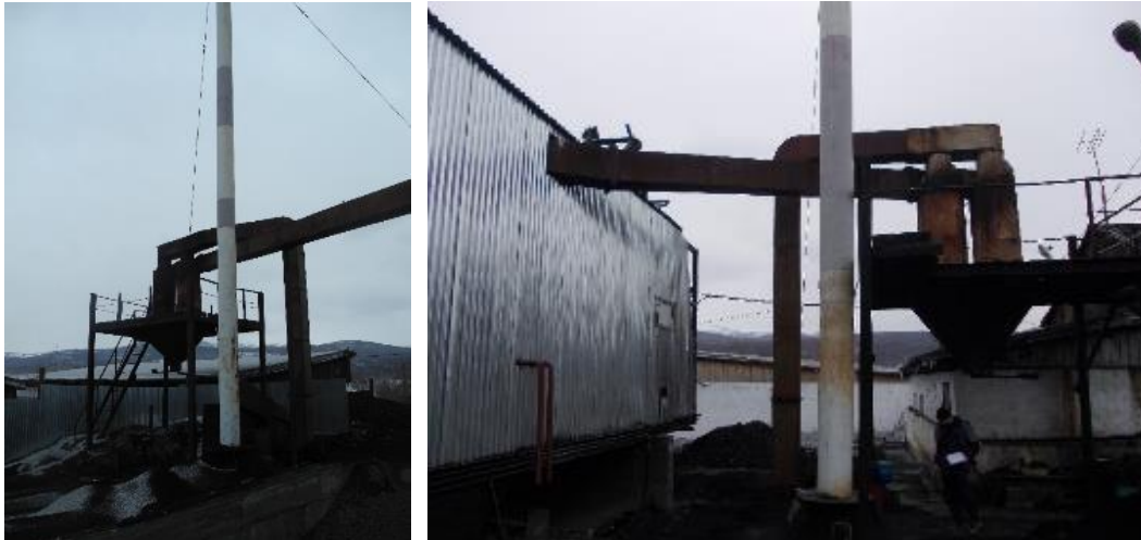
Рисунок 3.1.47 – Дымовые трубы котлов КВм – 2,5
