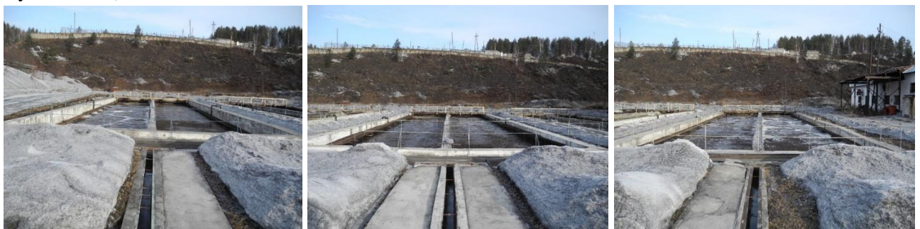
Рисунок 3.3.2 – Аэротенки очистных сооружений
