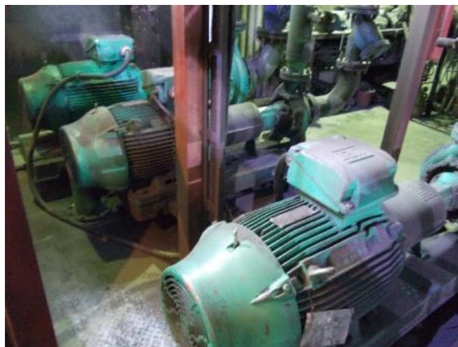
Рисунок 3.1.59 – Сетевые насосы Wilo NL 100/250-55-2-12, 55 кВт и Wilo NL 150/400-55-4-12, 55 кВт
