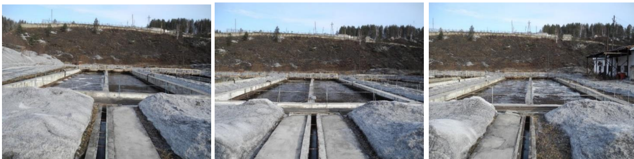
Рисунок 2.3.2 – Аэротенки очистных сооружений
