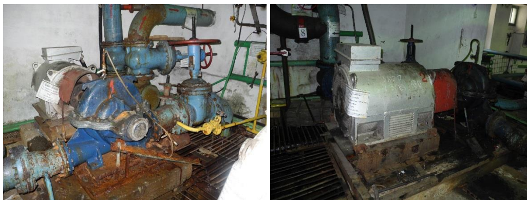
Рисунок 1.4.15 – Насосы 1Д630-90, установленные на НС №2
