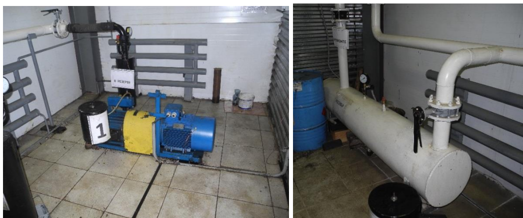
Рисунок 1.4.6 – Оборудование компрессорной станции
