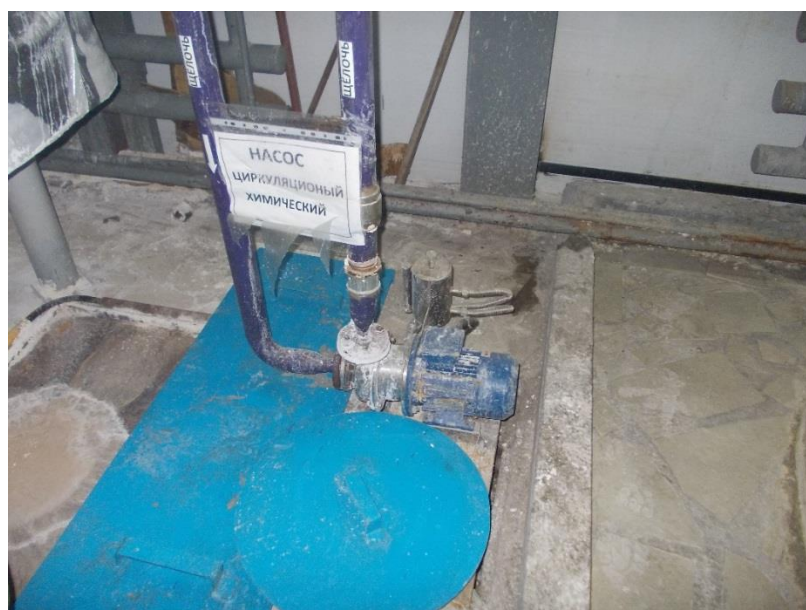
Рисунок 1.4.11 – Насос циркуляционный химический
