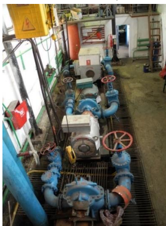
Рисунок 1.4.16 – Насосы типа 1Д630-90, установленные на НС №2
